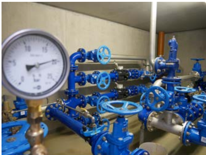
Rohrkeller Übergabeschacht Weihersmühle
