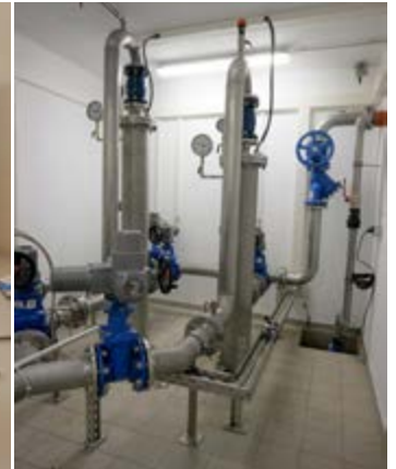
Wasserförderpumpen „In der Au“
