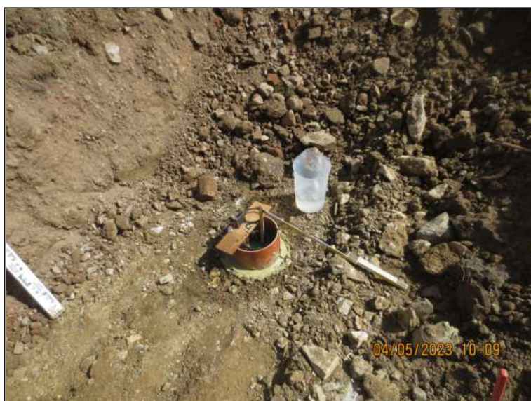
Bild-Nr. 6: Vorbereitungen für den Versickerungsversuch V1 bei 0,8 m u. GOK in Schurf 1.
